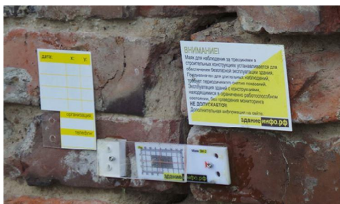
Рис. 3. – Маяк для наблюдения за трещинами
