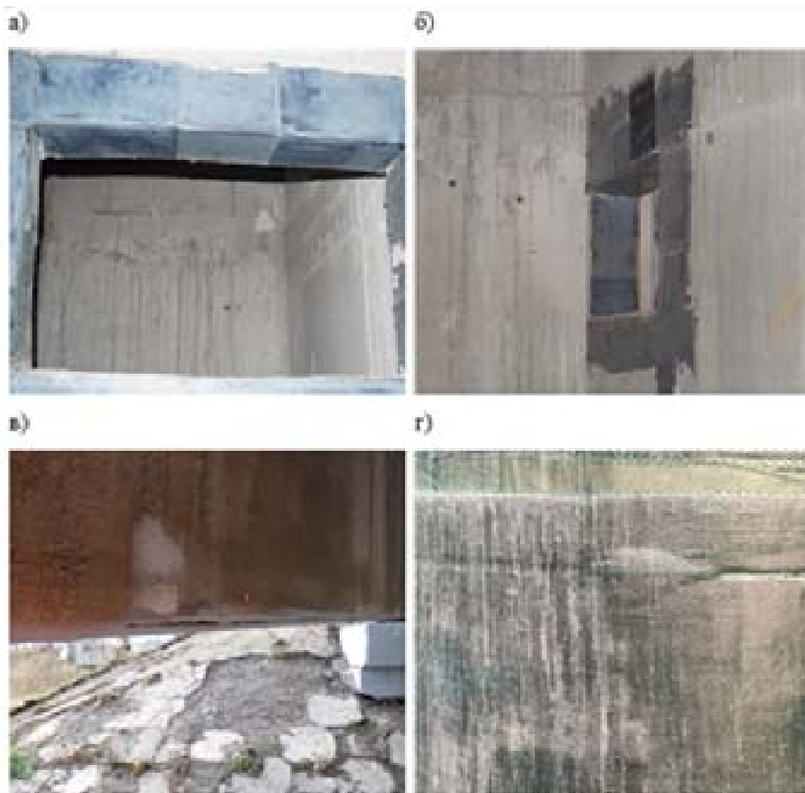
Рис. 1 – Наиболее распространенные дефекты систем внешнего армирования: а) недостаточное скругление ребра; б) непропитанные клеем участок холста; в) пустота в клеевом слое; г) пузырь воздуха под холстом
