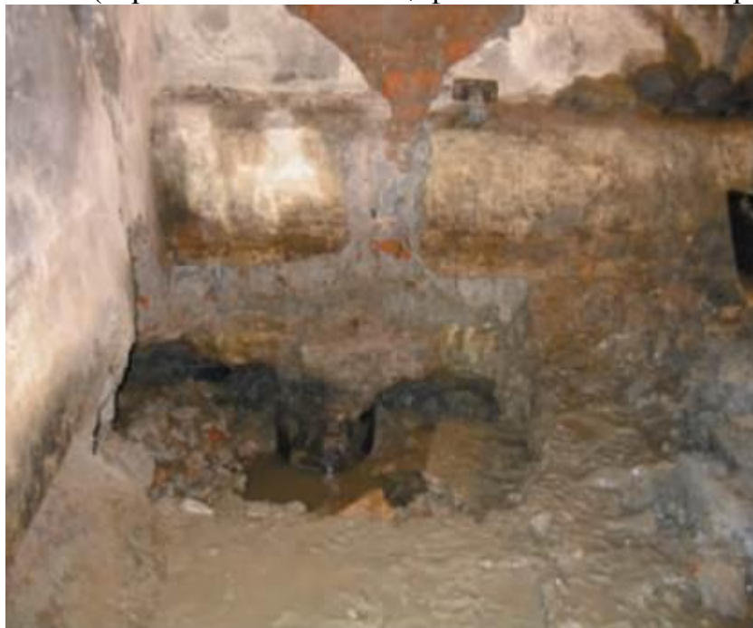
Рис. 4. Лежни и сваи под фундаментами здания по набережной р. Фонтанки, д. 7 (строительство 1832 г.; фото выполнено авторами).
