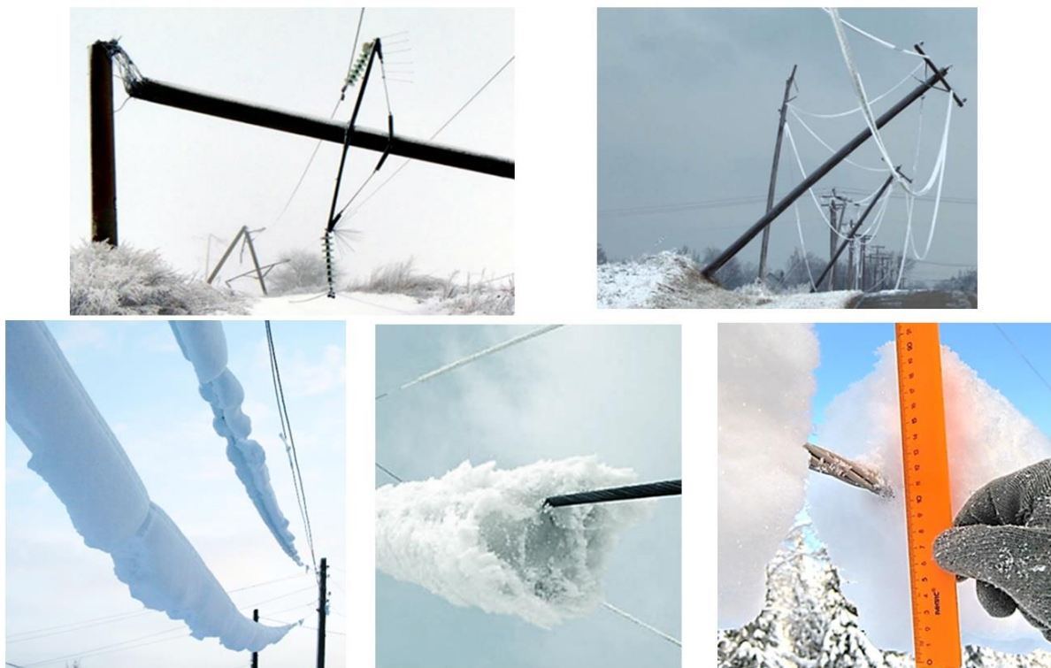
Рис. 1. Разрушение железобетонных опор ЛЭП в следствии воздействия мокрого снега, ветра и гололёда: сверху приведены фото разрушения опоры с
