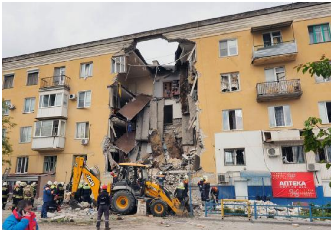
Рис. 2. – Объект №1 [11] классификации, разрушение на всю высоту здания
