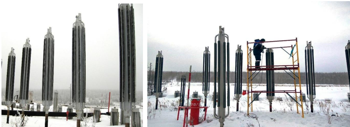
Рис. 2. 2, а) Глубинные СОУ; 2, б) обслуживание оборудования.
