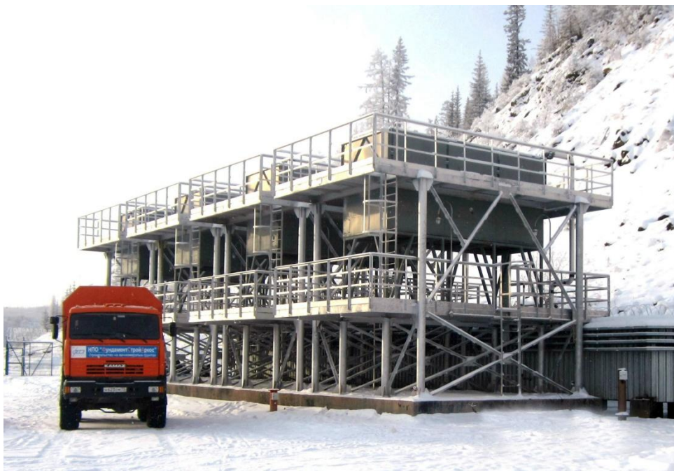
Рис. 4. Агрегаты воздушного охлаждения коллекторных СОУ.
